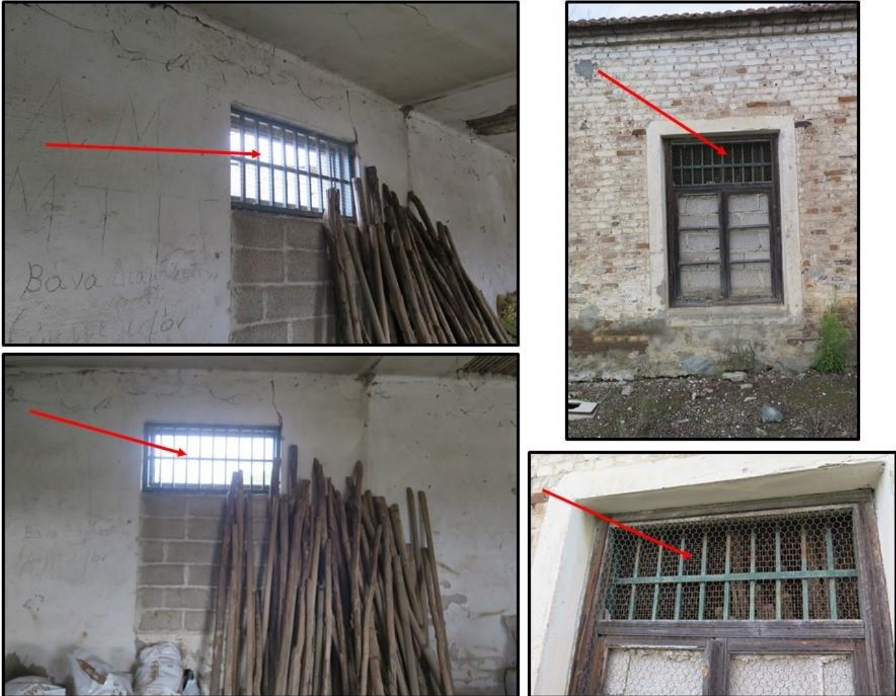
Εικόνα 34. Ανοίγματα (παράθυρα και πόρτα) χωρίς ικανοποιητική προστασία (προστατευτική σίτα) για την αποτροπή της εισόδου εντόμων σε αποθήκη οριζόντιου τύπου (Αποθήκη Δ) του Συνεταιρισμού «ΘΕΣγη» στον οικισμό Γυρτώνη. Με τα κόκκινα βέλη επισημαίνονται τα επίμαχα σημεία.
