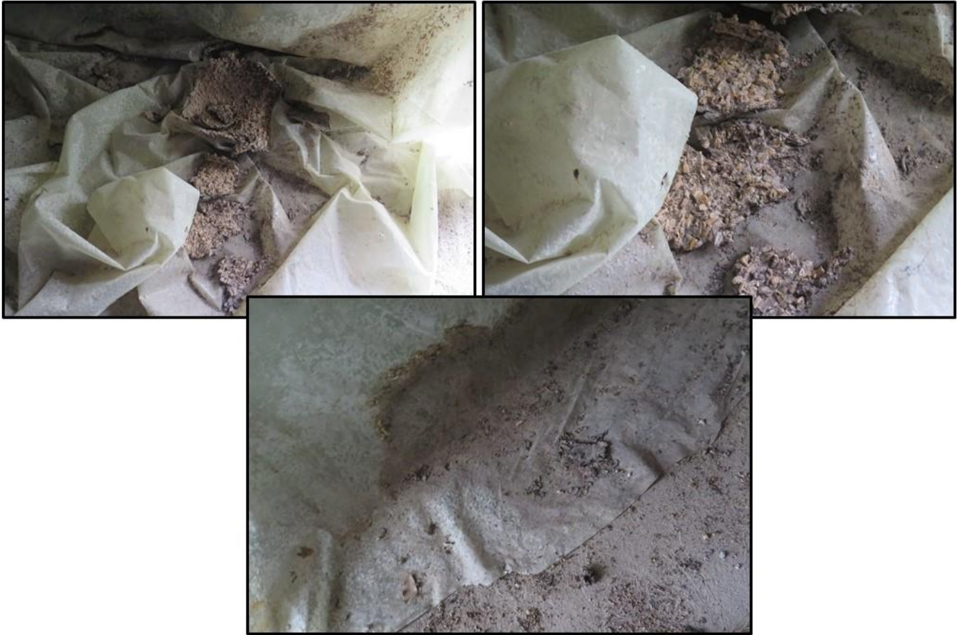
Εικόνα 49. Πλημμελής καθαρισμός – κακές συνθήκες υγιεινής σε αποθήκη οριζόντιου τύπου (Αποθήκη Ζ) του Συνεταιρισμού «ΘΕΣγη».
