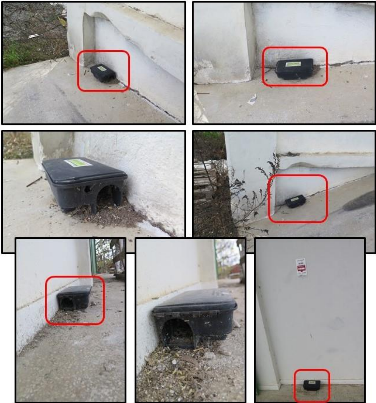
Εικόνα 77. Πλημμελής συντήρηση και λανθασμένη τοποθέτηση των δολωματικών σταθμών σε αποθήκη οριζοντίου τύπου του Συνεταιρισμού «ΘΕΣγη», συνολικής χωρητικότητας 460 τ.μ., στον οικισμό Γλαύκη του Νομού Λάρισας, που χρησιμοποιείται για την αποθήκευση γεωργικών προϊόντων.
