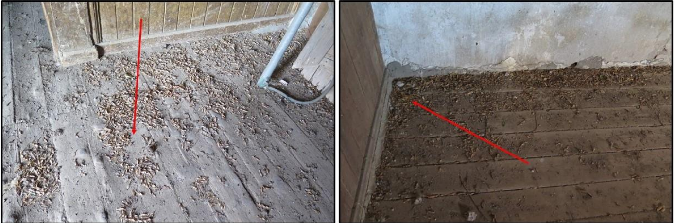
Εικόνα 42. Πλημμελής καθαρισμός – κακές συνθήκες υγιεινής σε αποθήκη οριζόντιου τύπου (Αποθήκη ΣΤ) του Συνεταιρισμού «ΘΕΣγη».
