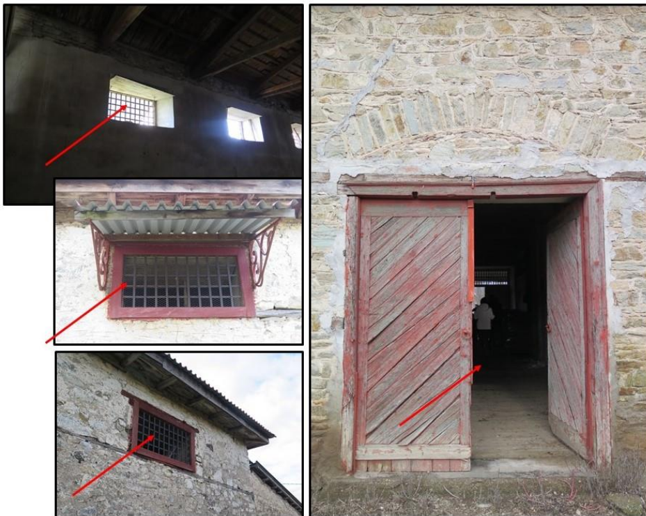
Εικόνα 45. Ανοίγματα (παράθυρα και πόρτα) χωρίς προστασία (προστατευτική σίτα) για την αποτροπή της εισόδου εντόμων σε αποθήκη οριζόντιου τύπου (Αποθήκη Ζ) του Συνεταιρισμού «ΘΕΣγη» στον οικισμό Γυρτώνη. Με τα κόκκινα βέλη επισημαίνονται τα επίμαχα σημεία.
