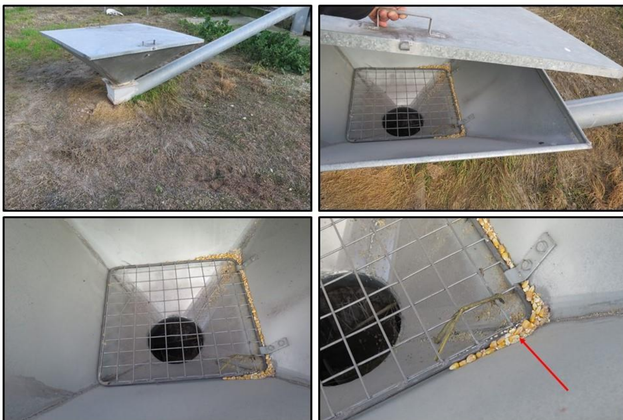
Εικόνα 84. Πλημμελής καθαρισμός και παρουσία προϊόντος στον μηχανισμό τροφοδοσίας του αποθηκευτικού σιλό συνολικής χωρητικότητας 1000 τόνων στον οικισμό της Γλαύκης του Νομού Λάρισας, που χρησιμοποιεί ο Συνεταιρισμός «ΘΕΣγη» για την αποθήκευση των παραγόμενων προϊόντων.
