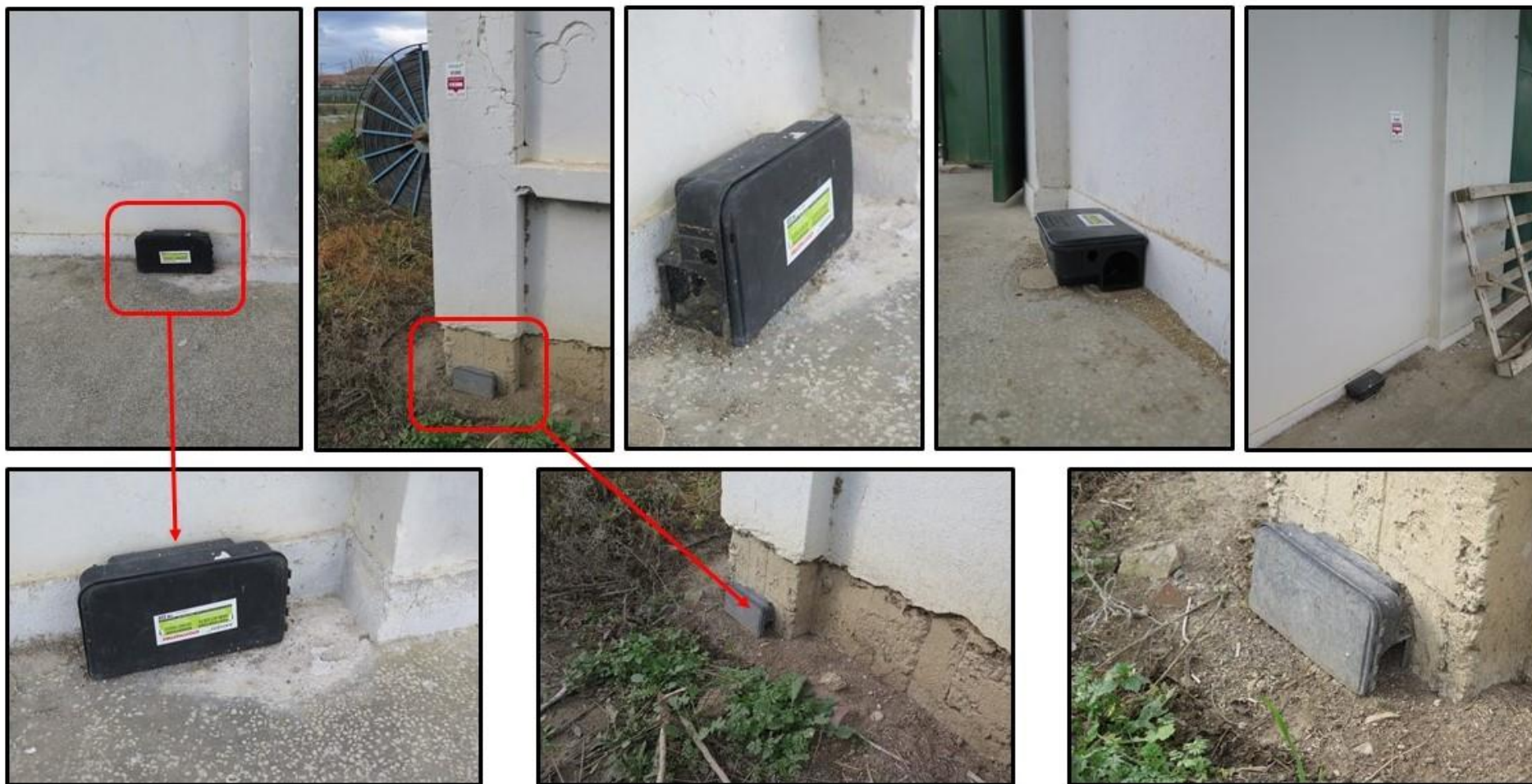
Εικόνα 78. Πλημμελής συντήρηση και λανθασμένη τοποθέτηση των δολωματικών σταθμών σε αποθήκη οριζοντίου τύπου του Συνεταιρισμού «ΘΕΣγη», συνολικής χωρητικότητας 460 τ.μ., στον οικισμό Γλαύκη του Νομού Λάρισας, που χρησιμοποιείται για την αποθήκευση γεωργικών προϊόντων.
