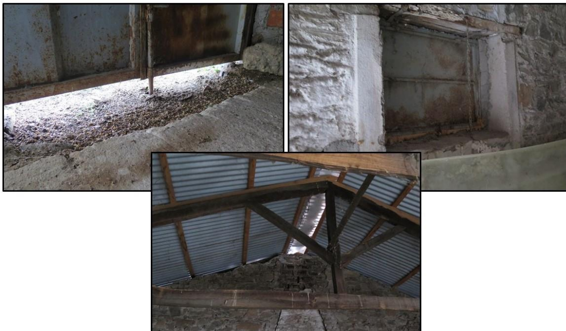
Εικόνα 48. Ανοίγματα (παράθυρα και πόρτα) χωρίς προστασία (προστατευτική σίτα) για την αποτροπή της εισόδου εντόμων και ανοίγματα στην οροφή σε αποθήκη οριζόντιου τύπου (Αποθήκη Ζ) του Συνεταιρισμού «ΘΕΣγη» στον οικισμό Γυρτώνη.
