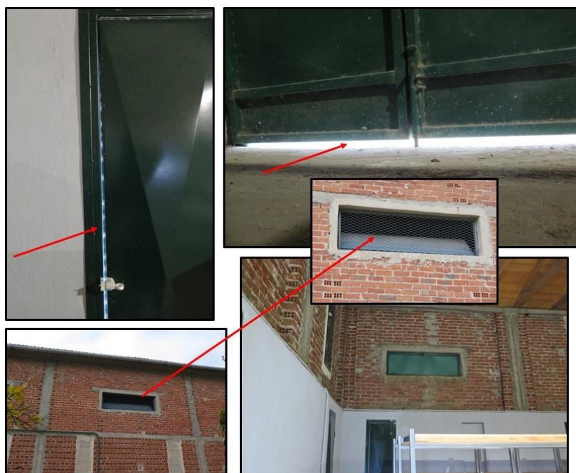
Εικόνα 30. Ανοίγματα (παράθυρα και πόρτα) χωρίς ικανοποιητική προστασία (προστατευτική σίτα, λωριδοκουρτίνες) για την αποτροπή της εισόδου εντόμων σε αποθήκη οριζόντιου τύπου (Αποθήκη Γ) του Συνεταιρισμού «ΘΕΣγη» στον οικισμό Γυρτώνη. Με τα κόκκινα βέλη επισημαίνονται τα επίμαχα σημεία.
