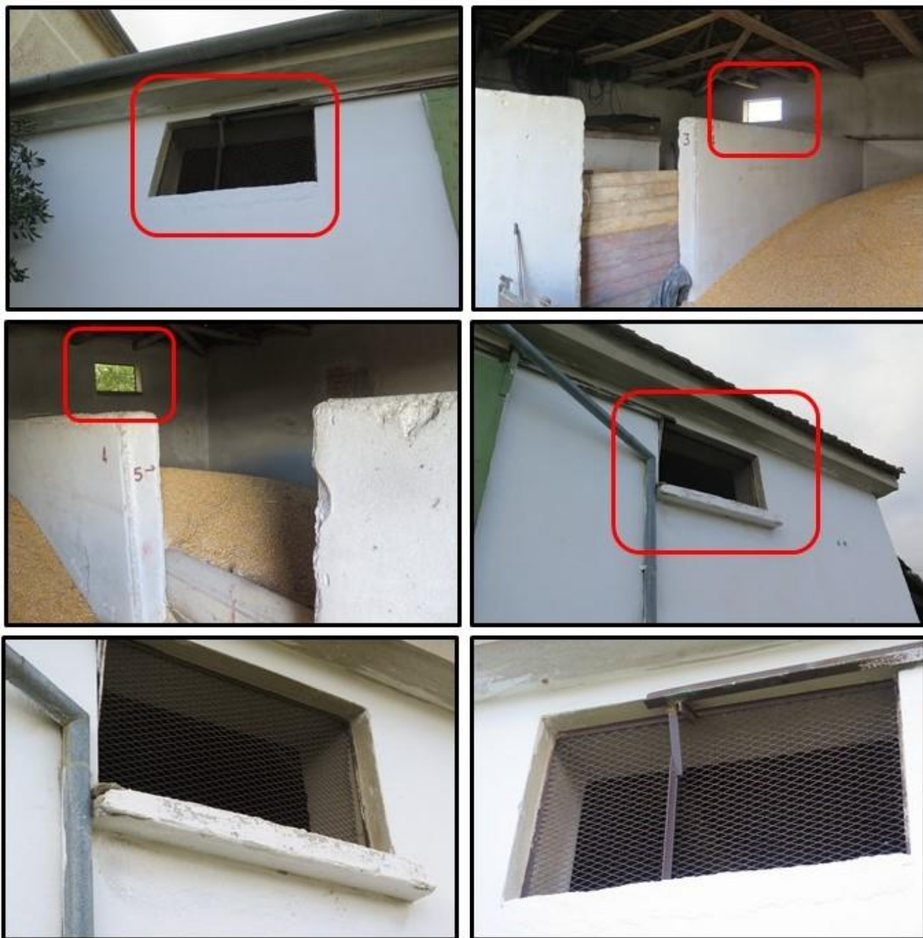
Εικόνα 70. Ανοίγματα (παράθυρα) χωρίς ικανοποιητική προστασία (προστατευτική σίτα) για την αποτροπή της εισόδου εντόμων σε αποθήκη οριζόντιου τύπου του Συνεταιρισμού «ΘΕΣγη» στον οικισμό Πλατυκάμπου του Νομού Λάρισας. Με τα κόκκινα πλαίσια επισημαίνονται τα επίμαχα σημεία.
